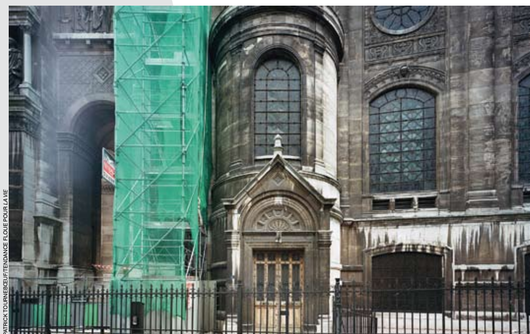
Saint-Augustin est dans « une situation désespérée ». La façade est protégée par un échafaudage.
