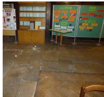
6. Bas-côté gauche de Saint-Philippe-du-Roule Pierres tombées de la voûte 8 novembre 2010 Photo : Didier Rykner
